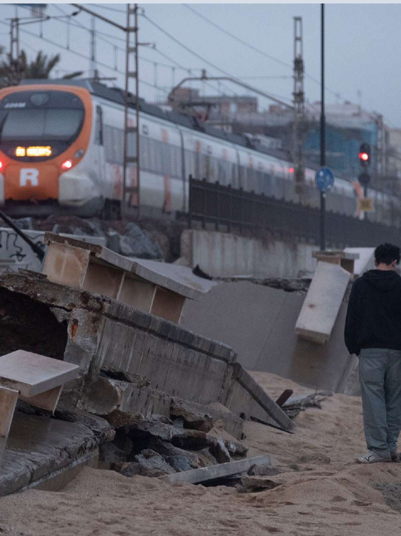
Daños en el paseo marítimo de la playa de la Barca María, que afectan a las vías del tren que conducen a Montgat, Badalona. © Pedro Armestre/ Greenpeace
