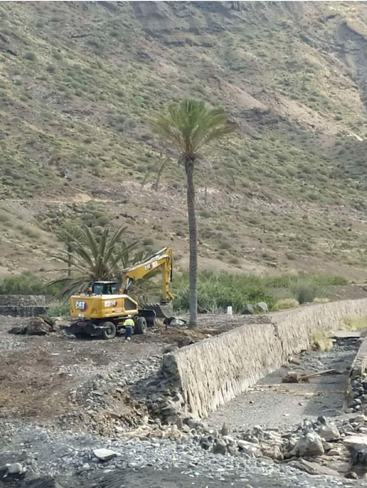
La playa de la Veneguera, una de las pocas playas vírgenes de Gran Canaria, ha sufrido movimientos de tierra masivos que han eliminado su talud natural de piedra y arena característico de la zona, alterando gravemente la dinámica sedimentaria y la integridad del ecosistema costero. Turcón-Ecologistas en Acción presentó denuncias ante la Fiscalía de Medio Ambiente y la Dirección General de Costas, quien ha abierto un expediente sancionador contra la empresa responsable, Costa Canaria de Veneguera, empresa filial del grupo hotelero Lopesan. © Greenpeace
