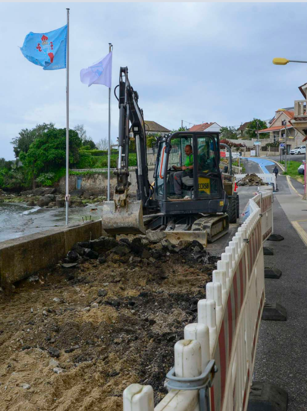
La playa y el paseo de O Con presentan un daño estructural irreversible ya que su base la fuerza hidráulica del ojeaje ha creado profundos socavones bajo el pavimento, dejando la estructura peatonal suspendida en el aire con un riesgo inminente de desplome. © Greenpeace
