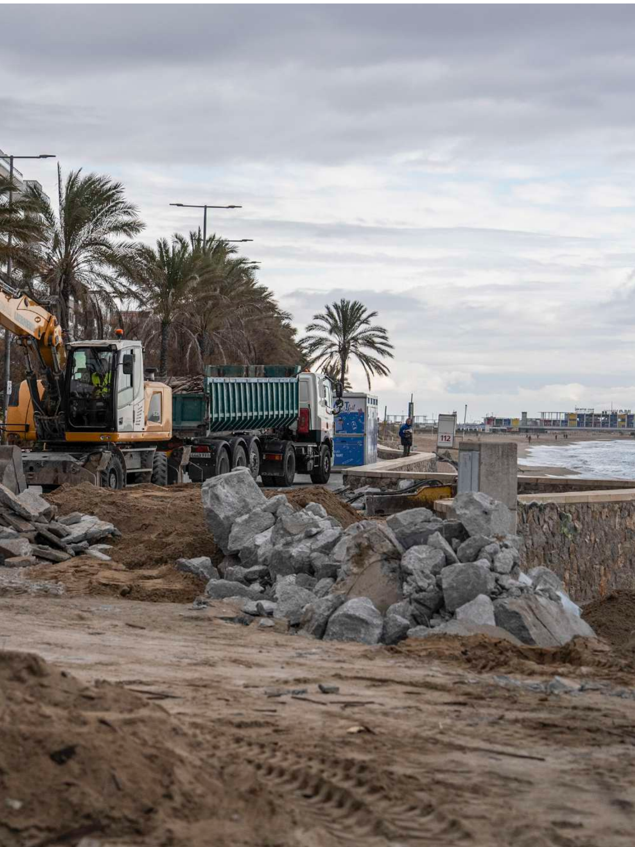
El temporal Harry causó graves daños estructurales, obligando al Ministerio para la Transición Ecológica a destinar 1,4 millones de euros en marzo de 2026 a reparaciones de emergencia en la Illa de Buda y Calafell, donde el oleaje descalzó el muro del paseo de Mas Mel. © Zowy voeten
