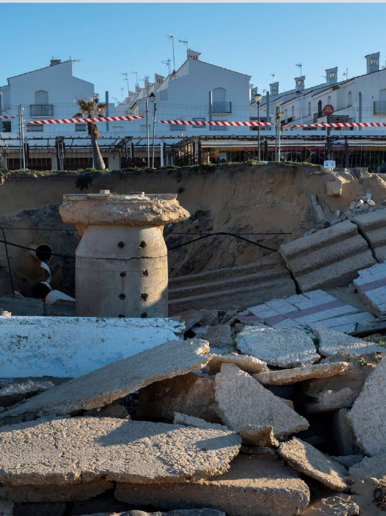
Daños en el paseo marítimo de Matalascañas, Huelva tras el paso de la borrasca Harry. © Pedro Armestre/ Greenpeace
