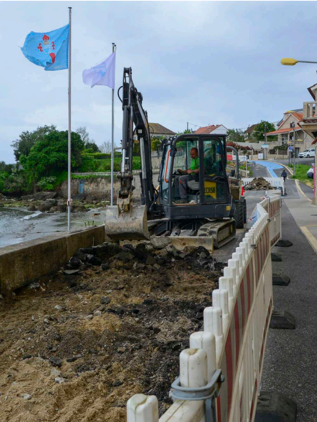
A praia e o paseo marítimo de O Con sufriron danos estruturais irreversibles; a forza hidráulica das ondas creou cavidades profundas baixo o pavimento, deixando a estrutura peonil suspendida no aire e en risco inminente de colapso.
